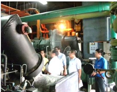
（設備の点検風景）
