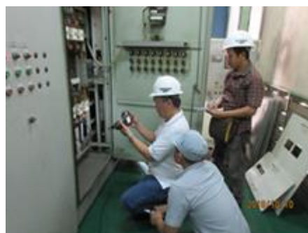
配電盤の電力分析（インドネシア）
