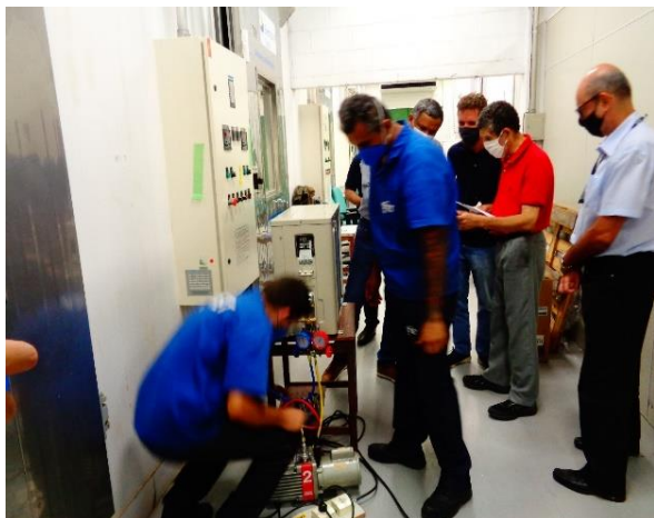
冷媒の計量と注入
