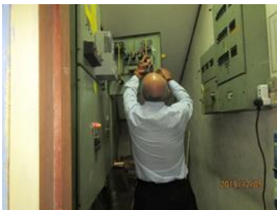
電力測定（段ボール工場）
