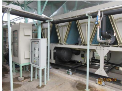
空冷ヒートポンプ式 Chiller が良く用いられている
