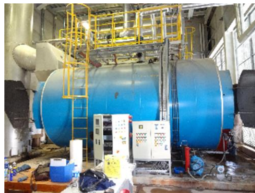
ボイラー外観
