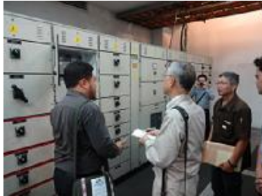
ホテル内電力測定
