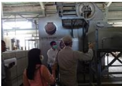
ボイラー診断（レンガ工場）
