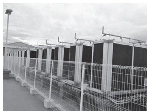
写真-2 エアポレーターシステムを設置後
