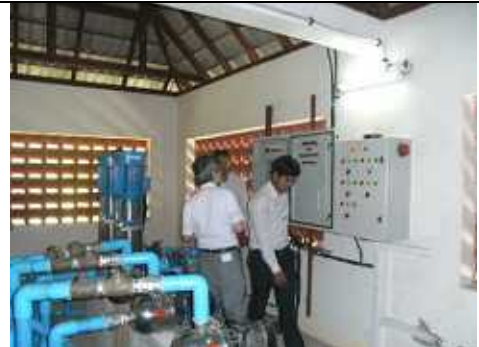
ビルのエネルギー管理現場実習
