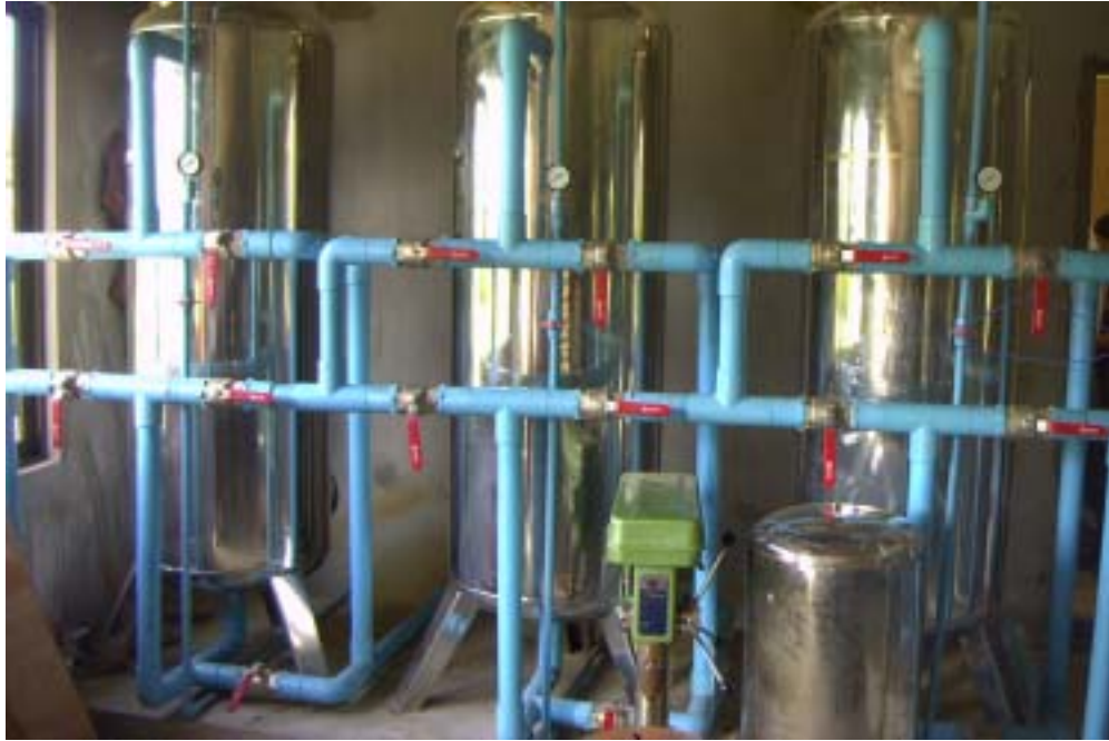
図Ⅲ－４－４ 水処理装置
