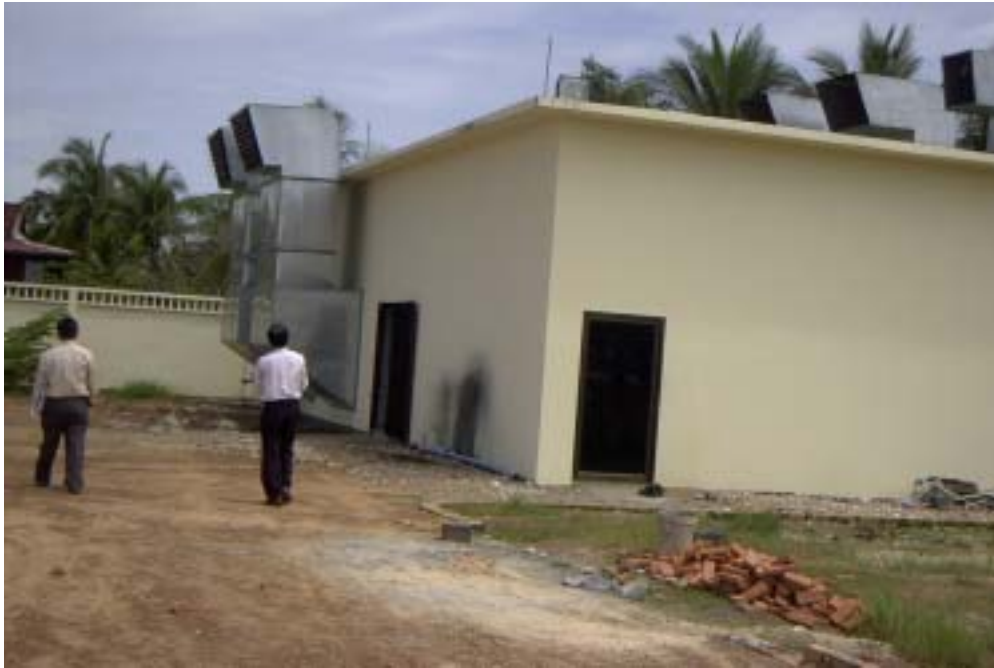
図Ⅲ－４－３ 発電機室
