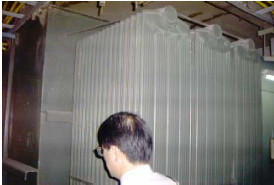
図V-4-16 老朽過大容量変圧器
